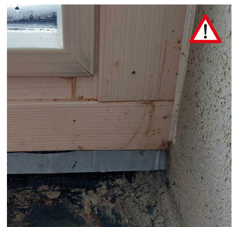
Dieses Holzfenster weist schwere Feuchtigkeitsschäden wie Stockflecken, Quellarbeiten bei Holzkanteln oder Blaufäule auf. Hier wurde nicht ausreichend gelüftet.
