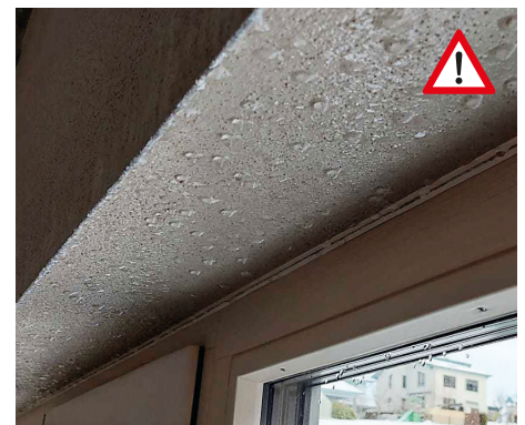
Bilden sich Stauwasser oder Tropfen an den Wänden, dann beträgt die Luftfeuchtigkeit weit über 55%. Es muss dringend gehandelt werden um schwere Schäden am Holz zu vermeiden.
